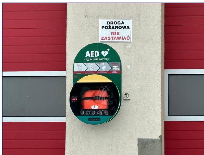
Defibrylator zamontowany na starej remizie strażackiej w Kołczygłowach
