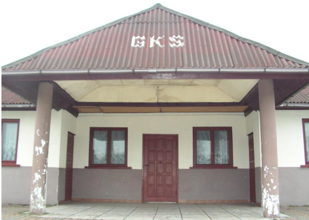
Budynek zaplecza sportowego przeznaczony do remontu.
